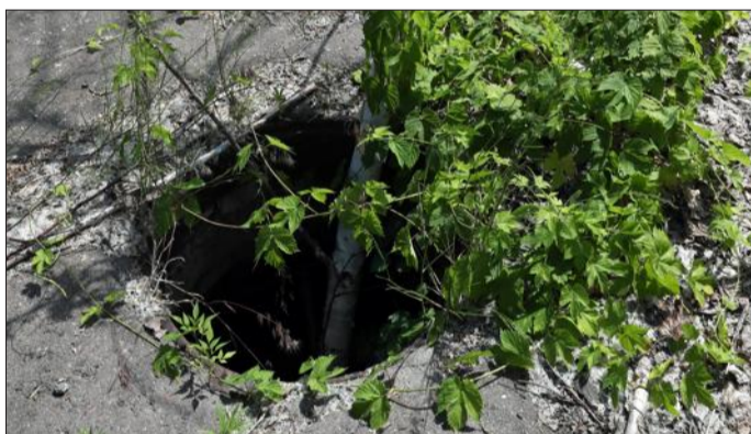
La plaque d'égout a été volée et revendue ; un bouleau s'y est installé. Photo L'Alsace
